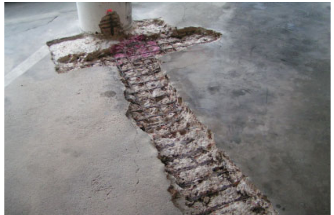
Bild 3. Teilweise korrodierte Bewehrung Fig. 3. Corrosion of reinforcement
