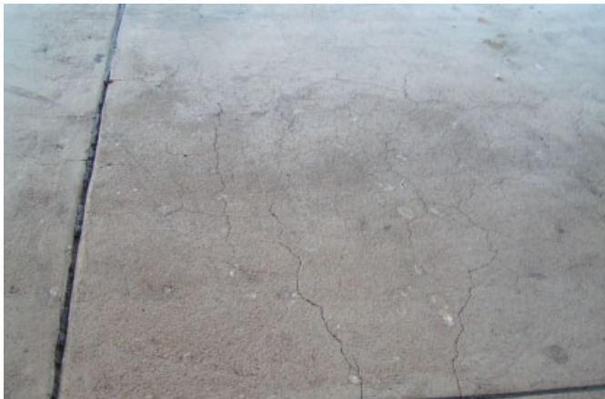
Bild 2. Rissbildung im Estrich Fig. 2. Crack formation in the screed
