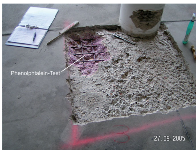
Bild 4. Überprüfung der Karbonisierungstiefe an einer frischen Stemmstelle
