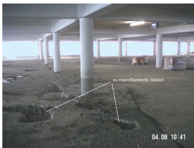
Bild 7. Schadhafte Stellen mit Betonausbruch, welche mittels geeigneter Instandsetzungsmaterialien reprofiliert werden mussten
