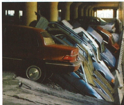
Abb. 1 – MONY Parkgarage in Syracuse, New York, Einsturz wegen Bewehrungskorrosion.
